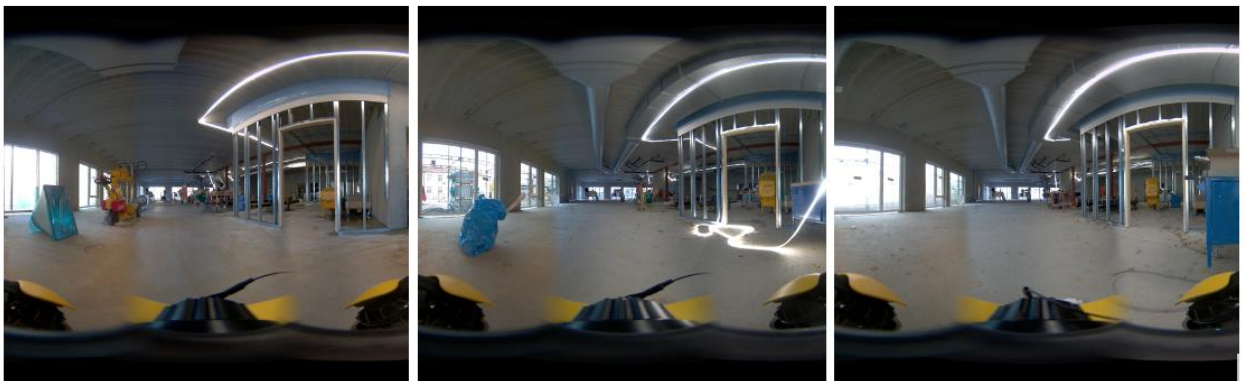
Bildserie 8. Bilder tagna av SpotCam+ under en trevockorsperiod. Notera rören i taket
